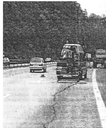
Bild 1: Bundesautobahn A81, Längsrisse in der Asphaltdecke [1]
